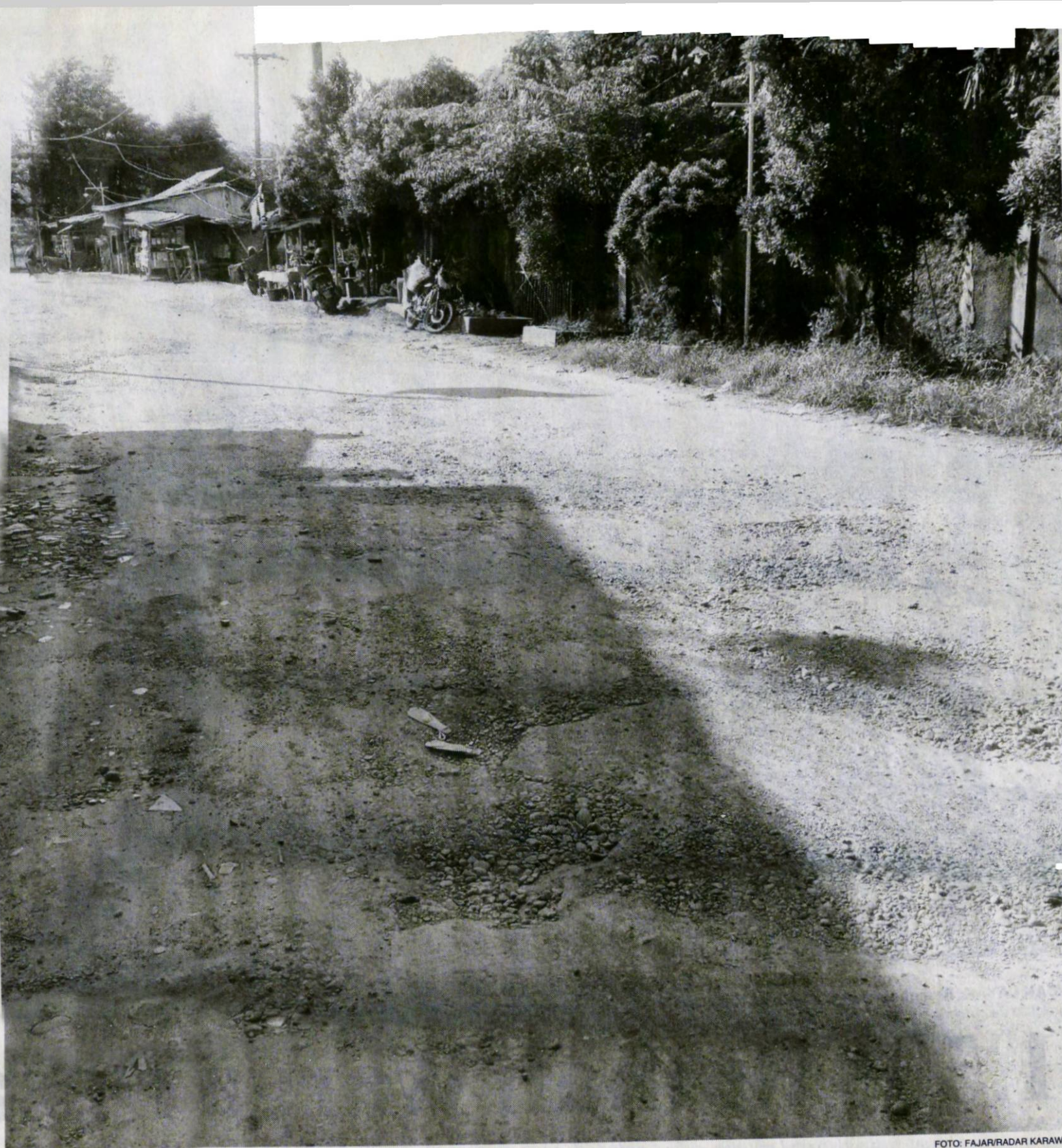
RUSAK PARAH: Kondisi jalan di Desa Walahar, Kecamatan Klari rusak. Selain berlubang, banyak bebatuan yang bisa membahayakan pengguna jalan terutama pengendara sepeda motor.
