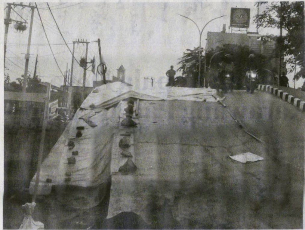
RUSAK: Jembatan KW 6 Karangpawitan amblas beberapa hari yang lalu.
